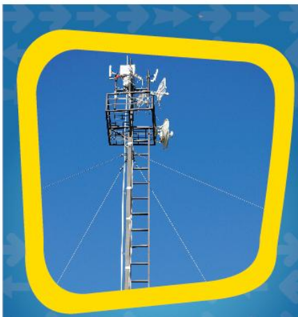
SISTEMA DE TELECOMUNICACIONES
